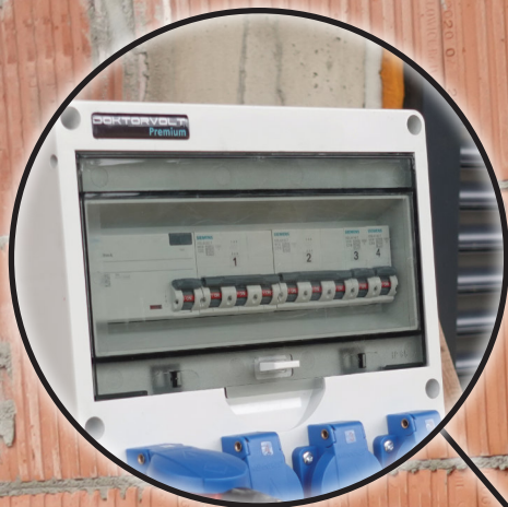
Zabezpieczenia Siemens, Doktorvolt
